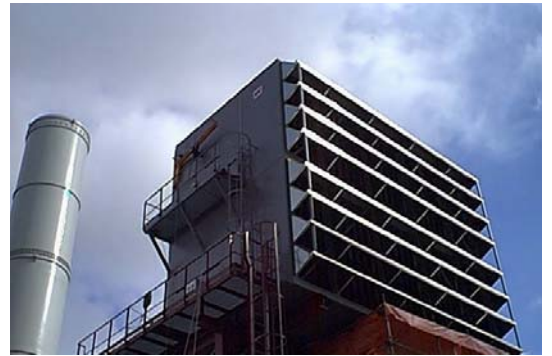
Caisson de filtration à l'aspiration d'une turbine à gaz
